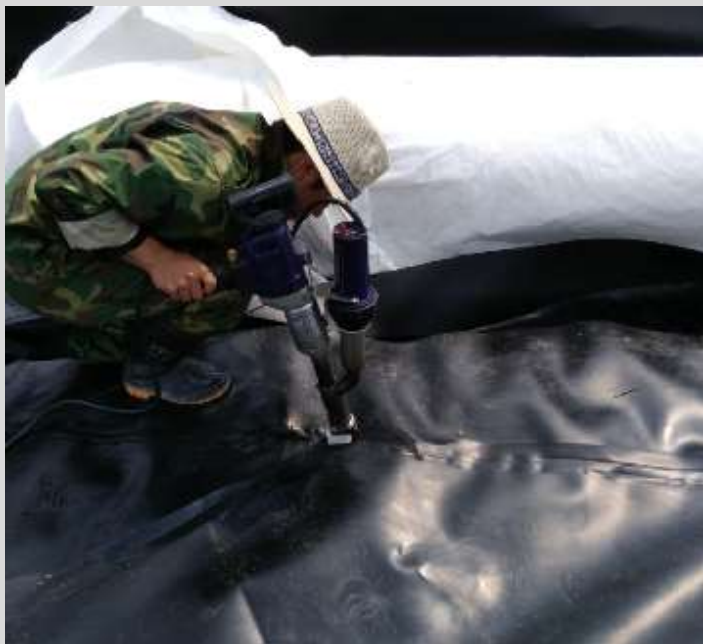
施工人员在浙江富阳农田改造项目上用 boosterEX3 挤出式焊机在土工膜层上修补
